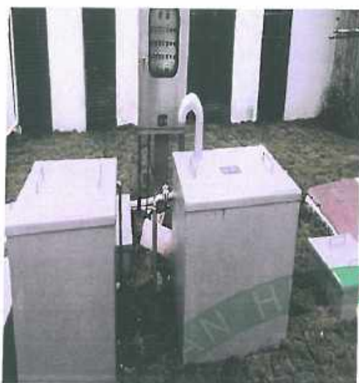
污水处理设施
